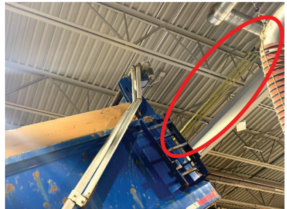
Photo 20 : Plafond limité en hauteur : risque d'accrocher certains éléments structuraux – l'ovale rouge indique des lignes de tension de 600 volts (atelier de BMA)
