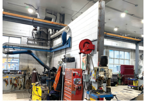
Photo 18 : Atelier de soudure à même l'atelier mécanique sans mur de séparation entre les deux ateliers pour limiter la propagation de la fumée de soudure (atelier d'Aylmer)
