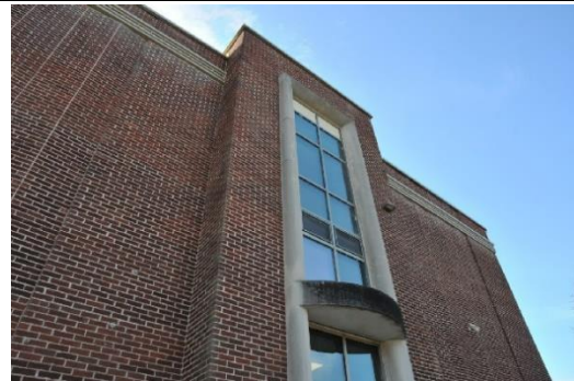
Image 5 : Détail façade, novembre 2022. Source : Ville de Gatineau
