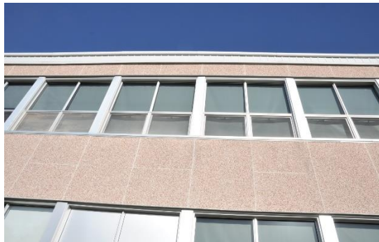
Image 7 : Détail façade, novembre 2022. Source : Ville de Gatineau
