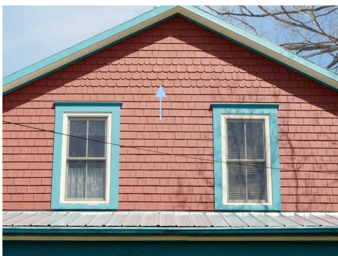
Revêtement de bardeau de bois. La partie inférieure de certains d'entre eux sont découpés (flèche). 29, rue Symmes, secteur d'Aylmer. P1020511.jpg
