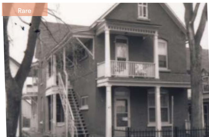
348. Plusieurs saillies sont présentes : une galerie, un balcon à auvent au-dessus de la porte principale et un escalier latéral. 57, rue Vaudreuil.
