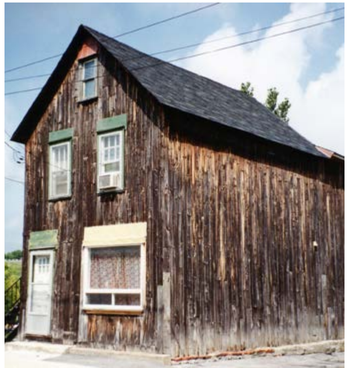
404. Les meneaux de la baie du rez-de-chaussée ont été remplacés par une menuiserie moderne. 1, rue Garneau.
