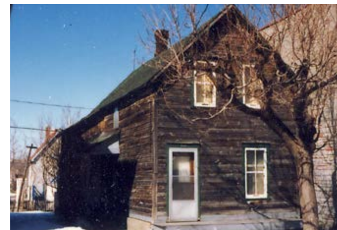
103. Composition symétrique, avec deux ouvertures centrées à l'étage. La porte est décentrée au rez-de-chaussée. 317, rue Champlain.
