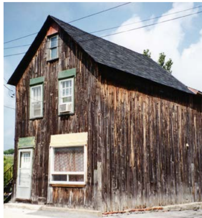
404. Les meneaux de la baie du rez-de-chaussée ont été remplacés par une menuiserie moderne. 1, rue Garneau.
