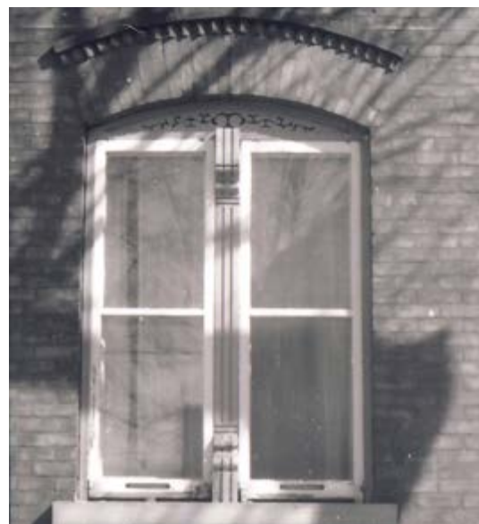
326. Fenêtre jumelée avec un piédroit ornementé, surmontée d'un arc surbaissé et d'une plate-bande ouvragé 154, rue Champlain.
